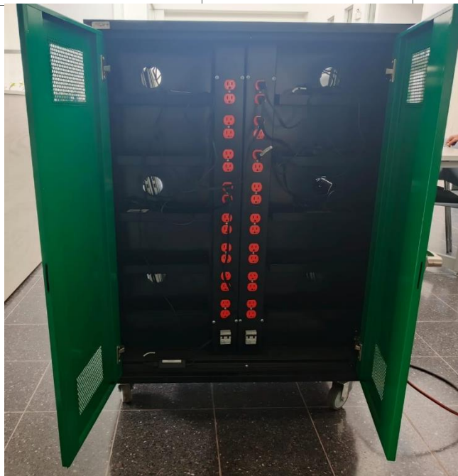
POSTERIOR - Tomas eléctricas reguladas - interruptor automático magnetotérmico
