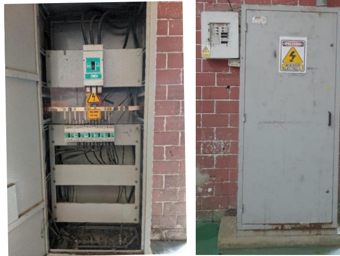
Imagen 3, Tablero de distribución actual, BQ-D
