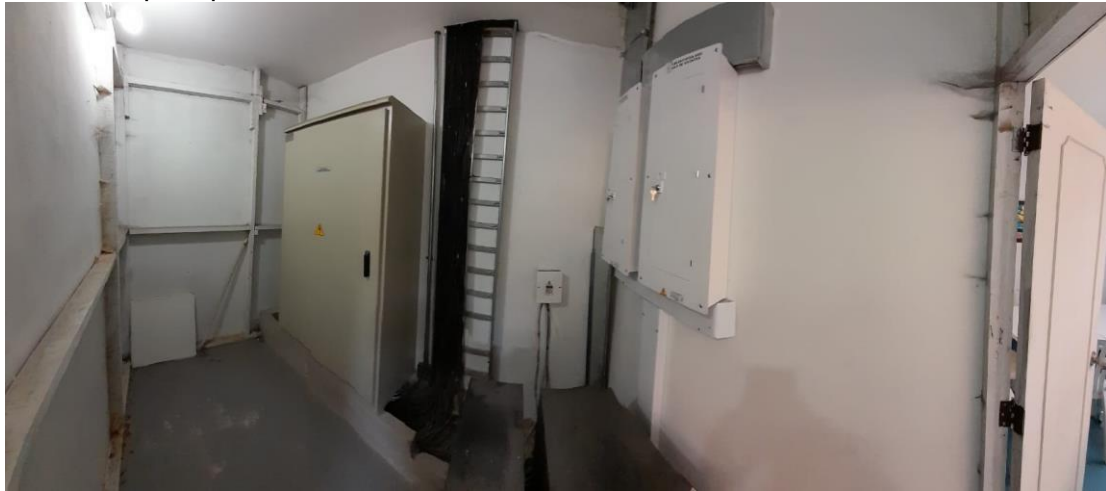
Imagen 9, Cuarto electrico BQ-C.
