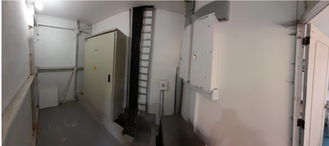
Imagen 16, Cuarto electrico BQ-C.
