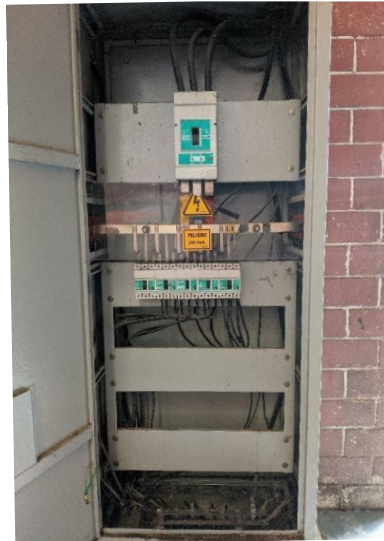
Imagen 3, Tablero de distribución actual, BQ-D
