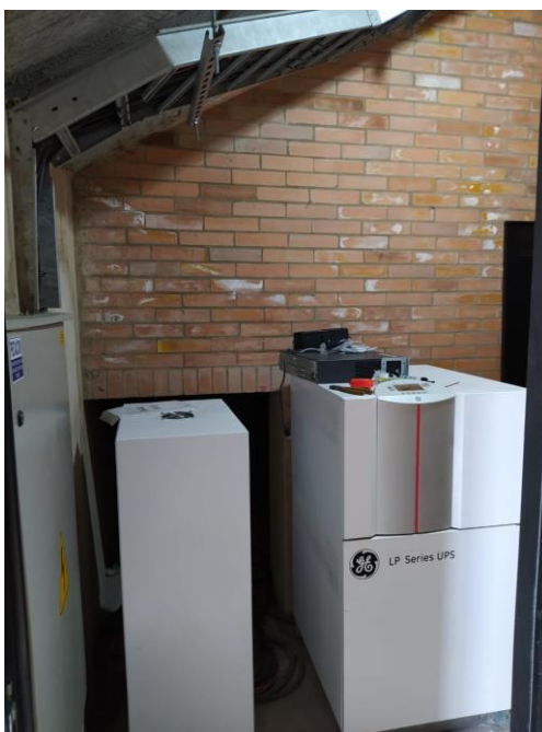
Figura 12 UPS GE LP50-33 más banco de baterías
