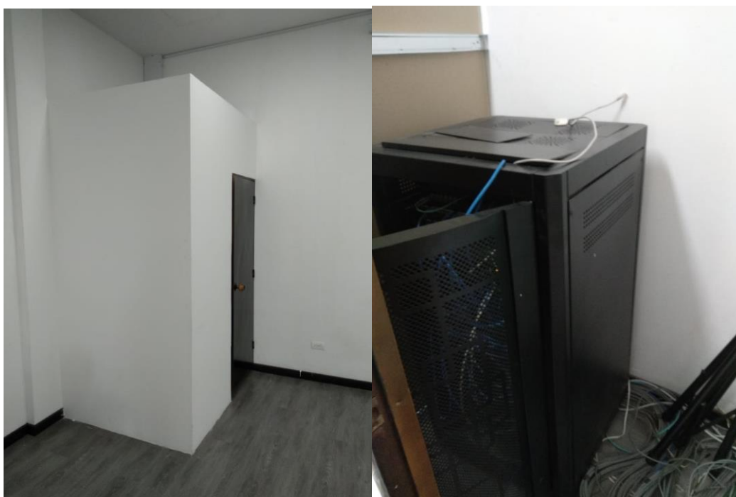
Figura 8. Estado Actual RACK TR2 – Extensión Chía
