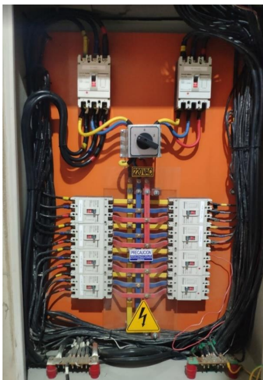
Figura 13 Tablero BYPASS Actual
