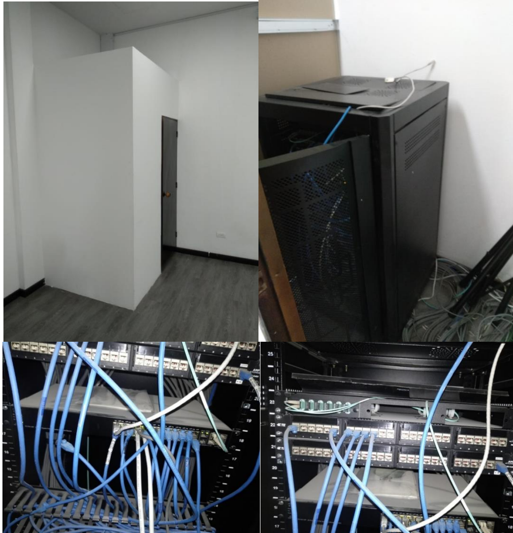
Imagen 4. Estado Actual RACK TR2 – Extensión Chía
