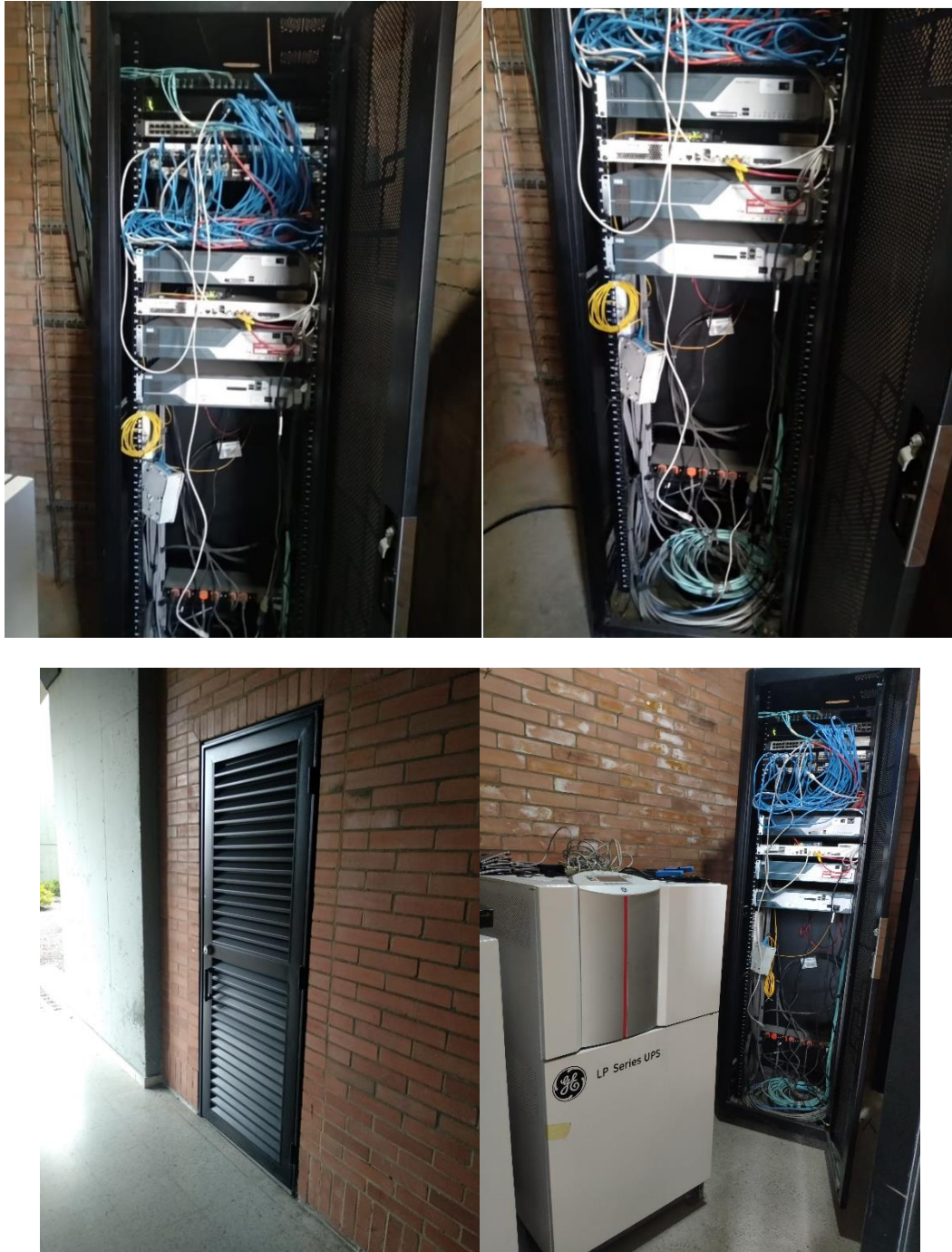
Imagen 2. Estado Actual RACK CD1 – Principal- Extensión Chía
