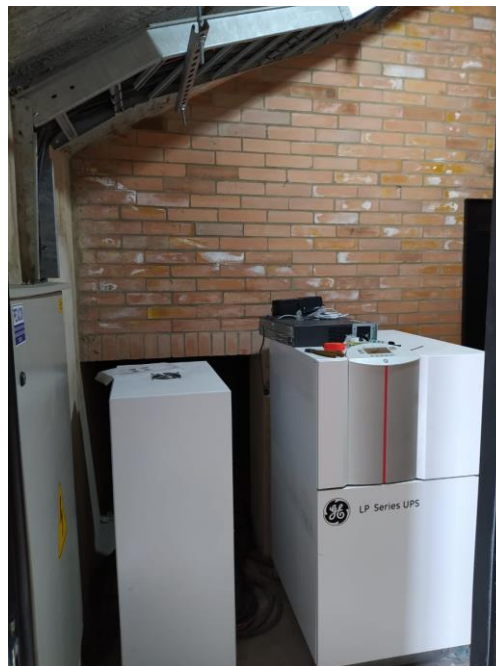
Imagen 8. UPS GE LP50-33 más banco de baterías
