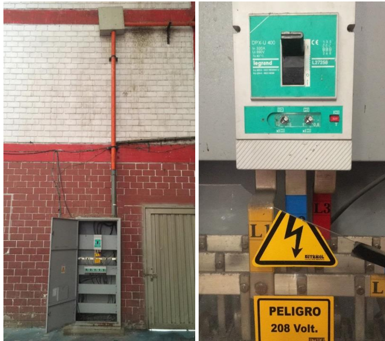
Totalizador del edificio
