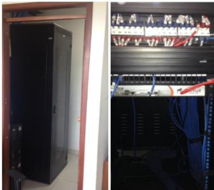
Imagen 5. Estado actual Rack TR1 - Bloque C
