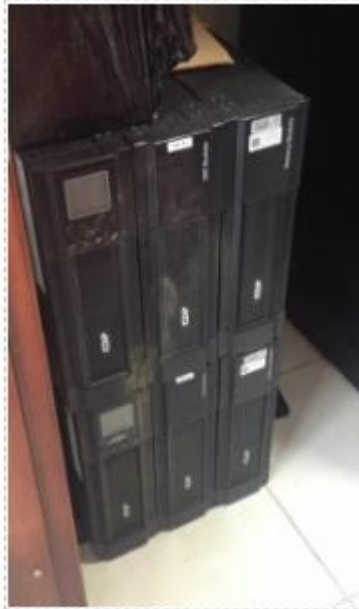
Imagen 6. Banco de Baterías UPS TR1 - Bloque C
