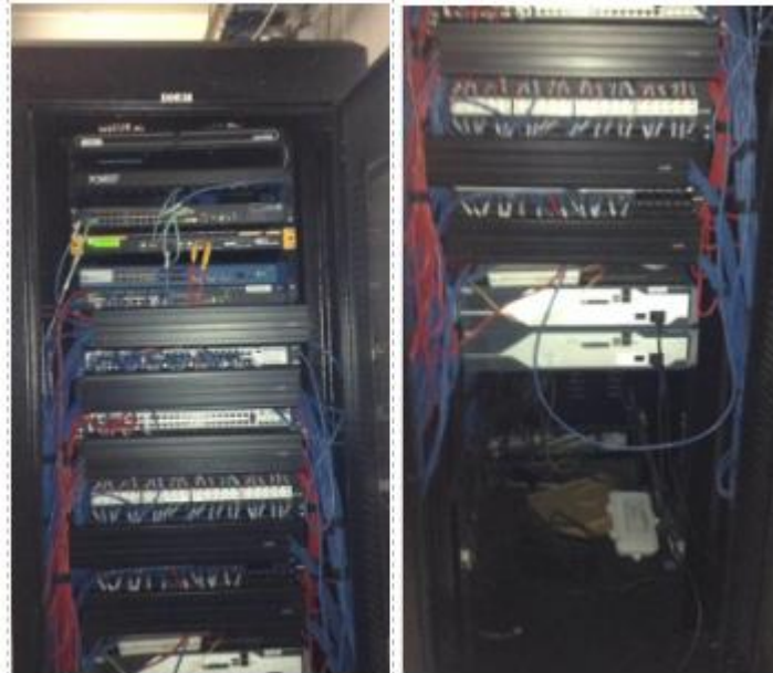
Imagen 4. Estado actual Rack CD1 - Bloque A
